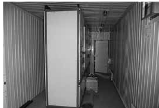
Щит СМП в контейнере
