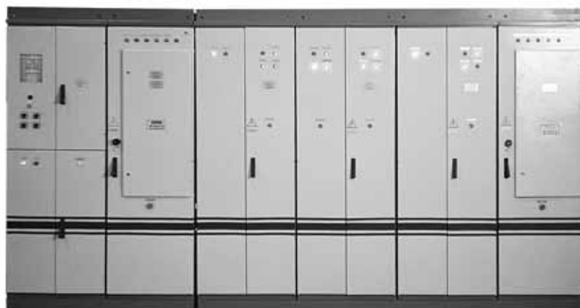
Щит СМП 6 кВ, 200 А для пуска четырех двигателей с применением двух ВПУ
