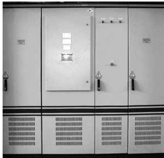
Щит преобразователя частоты ПЧИТ 1000 кВт
