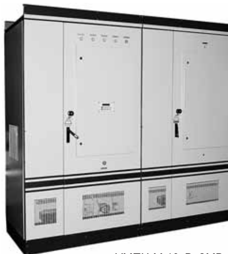
УМПЧ-М 10кВ, 2МВт
